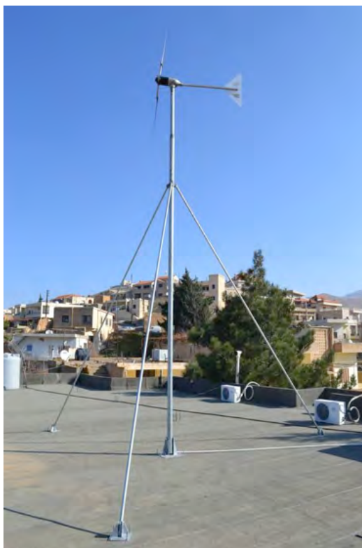
Image 14: Une petite turbine éolienne installée par CEDRO [26]
