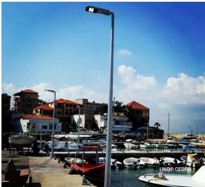
Image 15: Ampoules DEL à haut rendement énergétique pour l'éclairage de la rue, installées par CEDRO [27]
